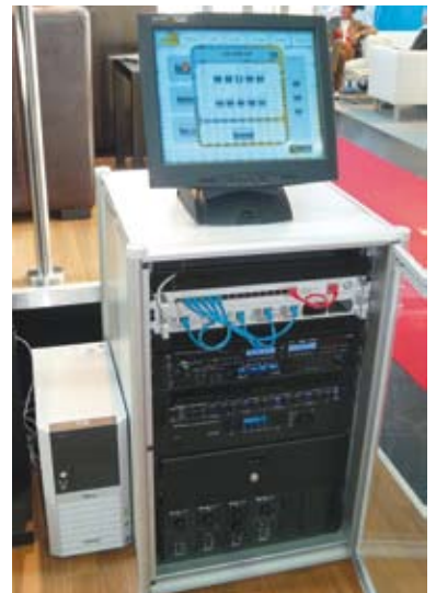
Im netzwerkfähigen ELA-Schrank fügen sich hochwertige Multimedia-Komponenten zu einem leistungsfähigen Ganzen zusammen
